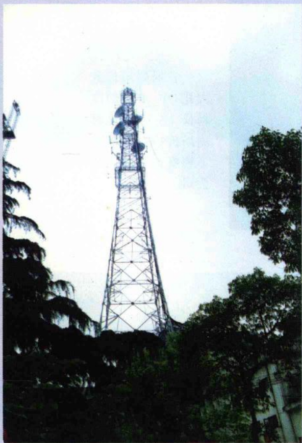
地区局无线通信铁塔。
