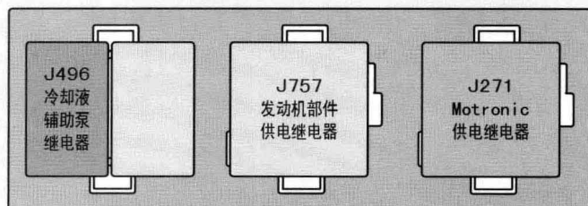
排水槽左侧电控箱中的继电器 (5.0L)
