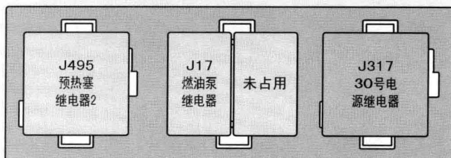
排水槽左侧电控箱中的继电器 (柴油)
