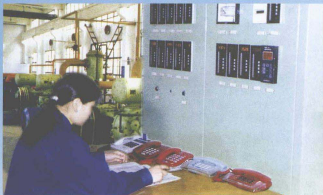
煤气输配车间
