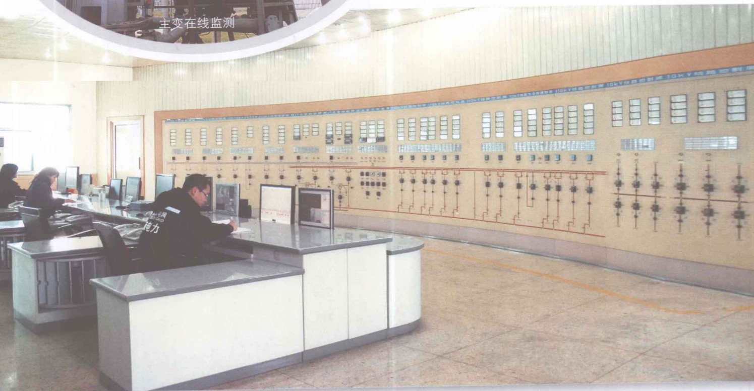
220千伏灵山集控站
