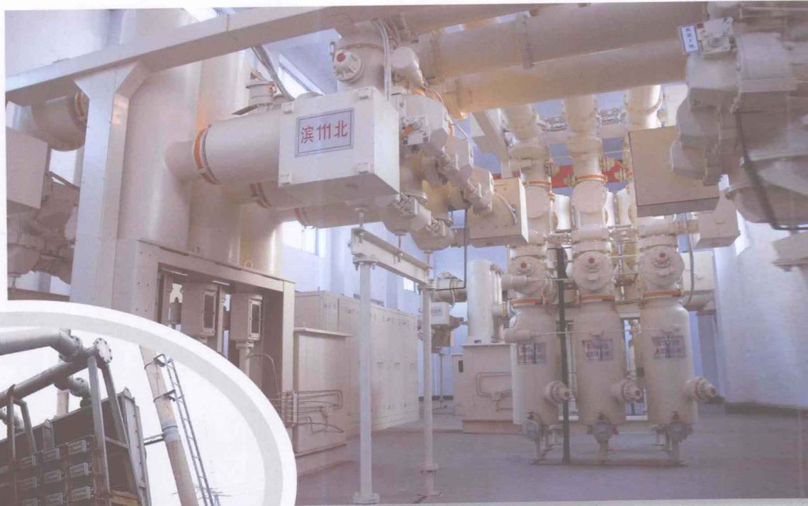
淇滨变110千伏GIS组合电器
