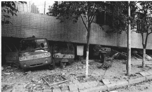
图 1.1-18 填充墙导致结构下柔上刚的震害
