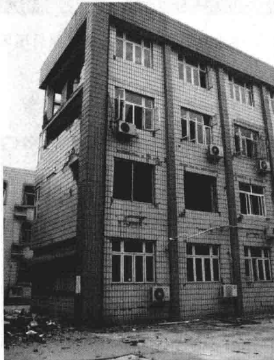
图 1.1-17 某 4 层框架结构填充墙的倒塌
