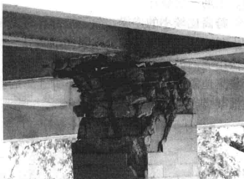
图 1.1-11 汶川地震某框架强柱弱梁破坏
