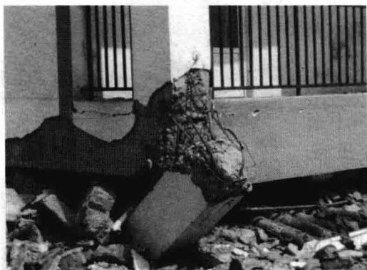
图 1.1-8 都江堰某5层框架结构柱折断
