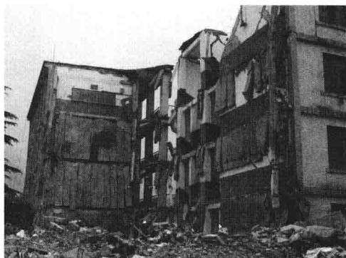
图 1.1-2 汶川地震某预制装配结构破坏
