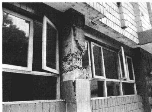
图 1.1-12 绵竹某 4 层框架短柱破坏
