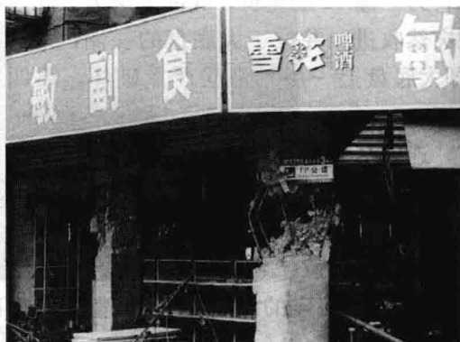
图 1.1-9 都江堰某6层底框底层柱头加腋破坏
