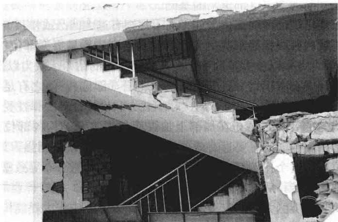
图 1.1-19 映秀某框架结构楼梯破坏
