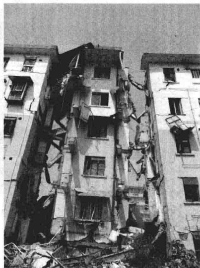
图 1.1-6 汶川地震中连廊倒塌
