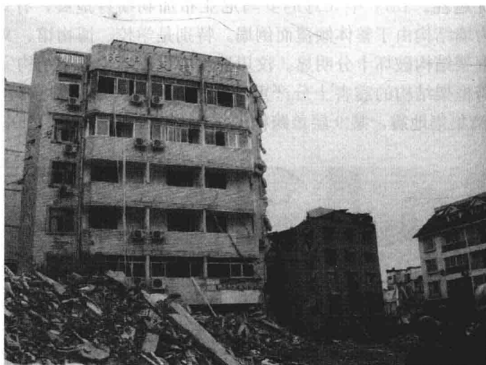
图 1.1-3 汶川地震都江堰某框架结构平面不规则的震害
