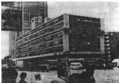
图 1.1-5 阪神地震某结构 SRC 柱变为 RC 柱中间层破坏
