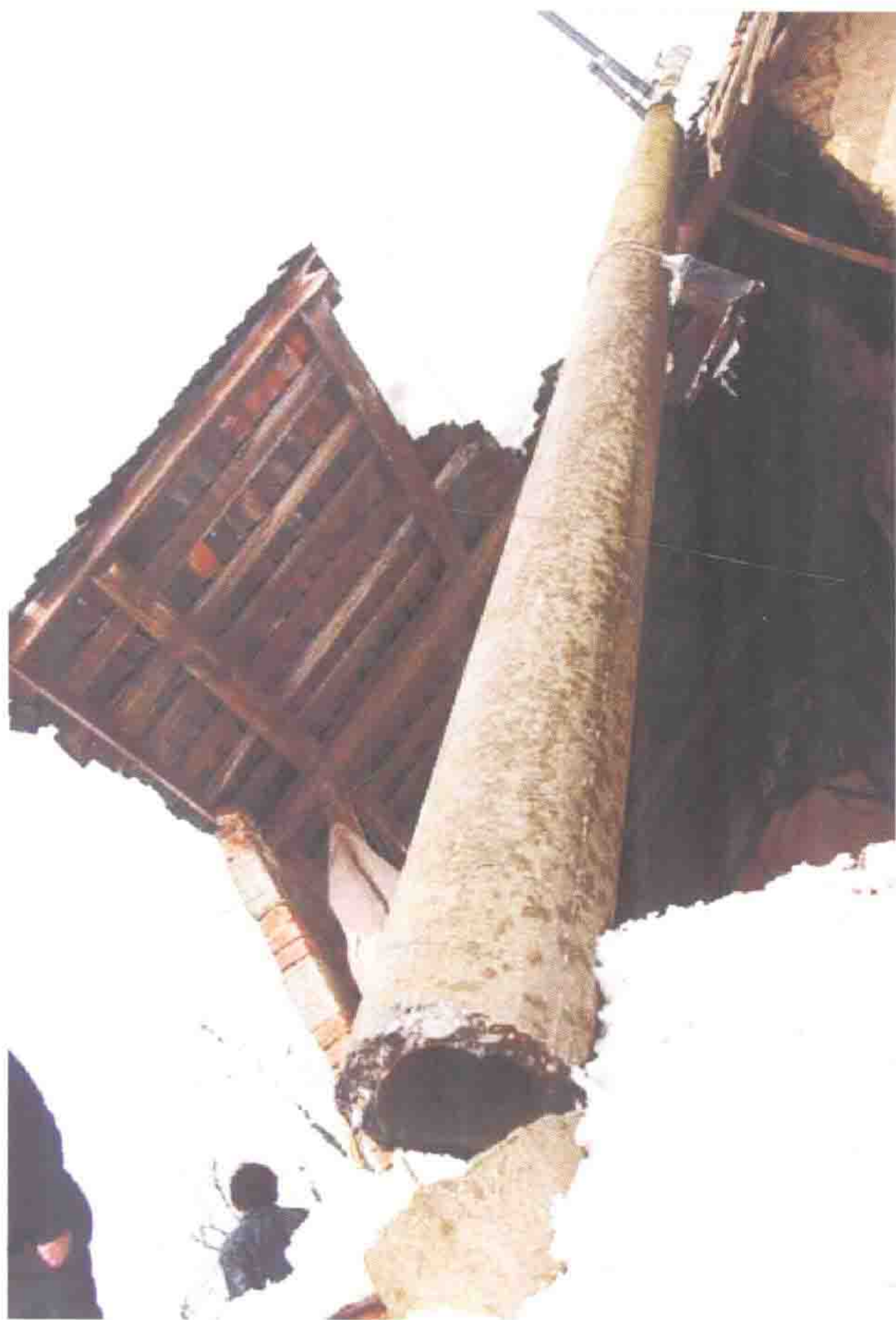
宜昌10千伏青岗坪线
