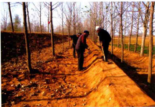
卫河河务局开展“消垦堤、守边界” 工程管理专项整治活动
