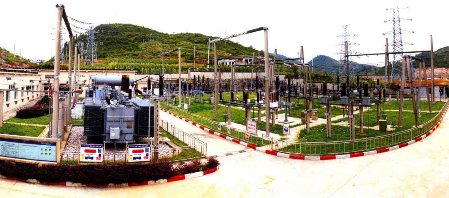
中枢变电站 (2011年6月摄) (图23)
