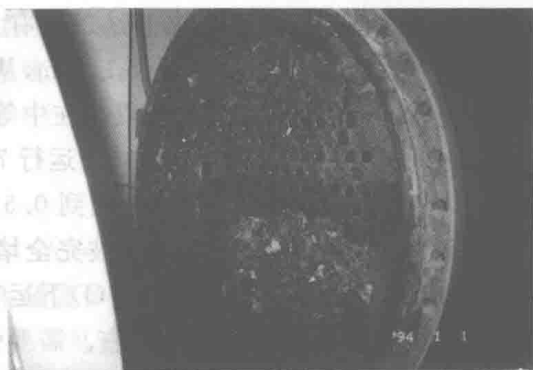
图 1-3 被原生城市原生污水阻塞与污染的换热设备
