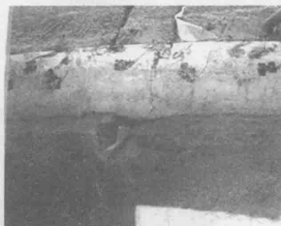
(a) 地裂缝环境下隧道衬砌破坏
