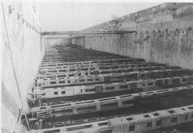
车站基坑内用锚杆、钢支撑和连续墙组成的复合支护体系
