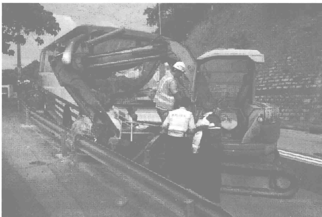
图6-3 路桥维修难安全,驾车经此不疯狂
