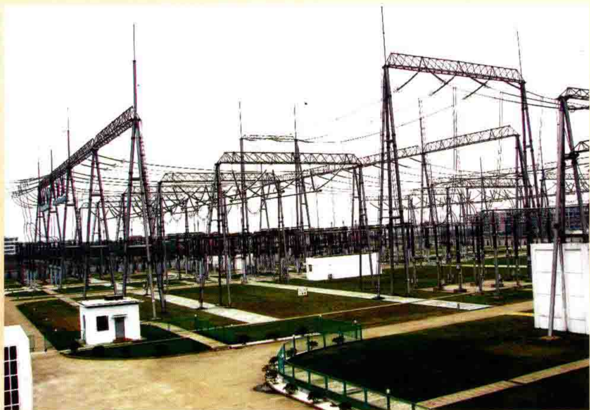
110千伏变电站（高桥）
