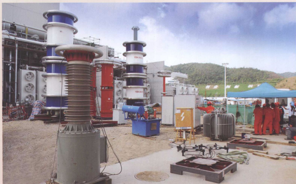
2009年4月14日，岭澳核电站二期工程1号机组主变压器及厂用变压器耐压实验
