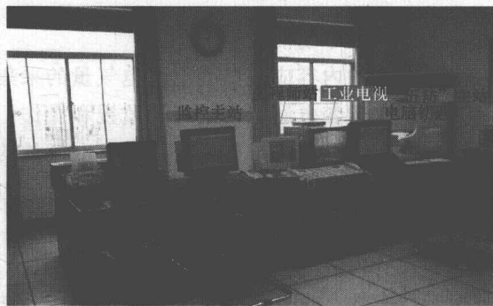
图 1-5 某变电站监控室
