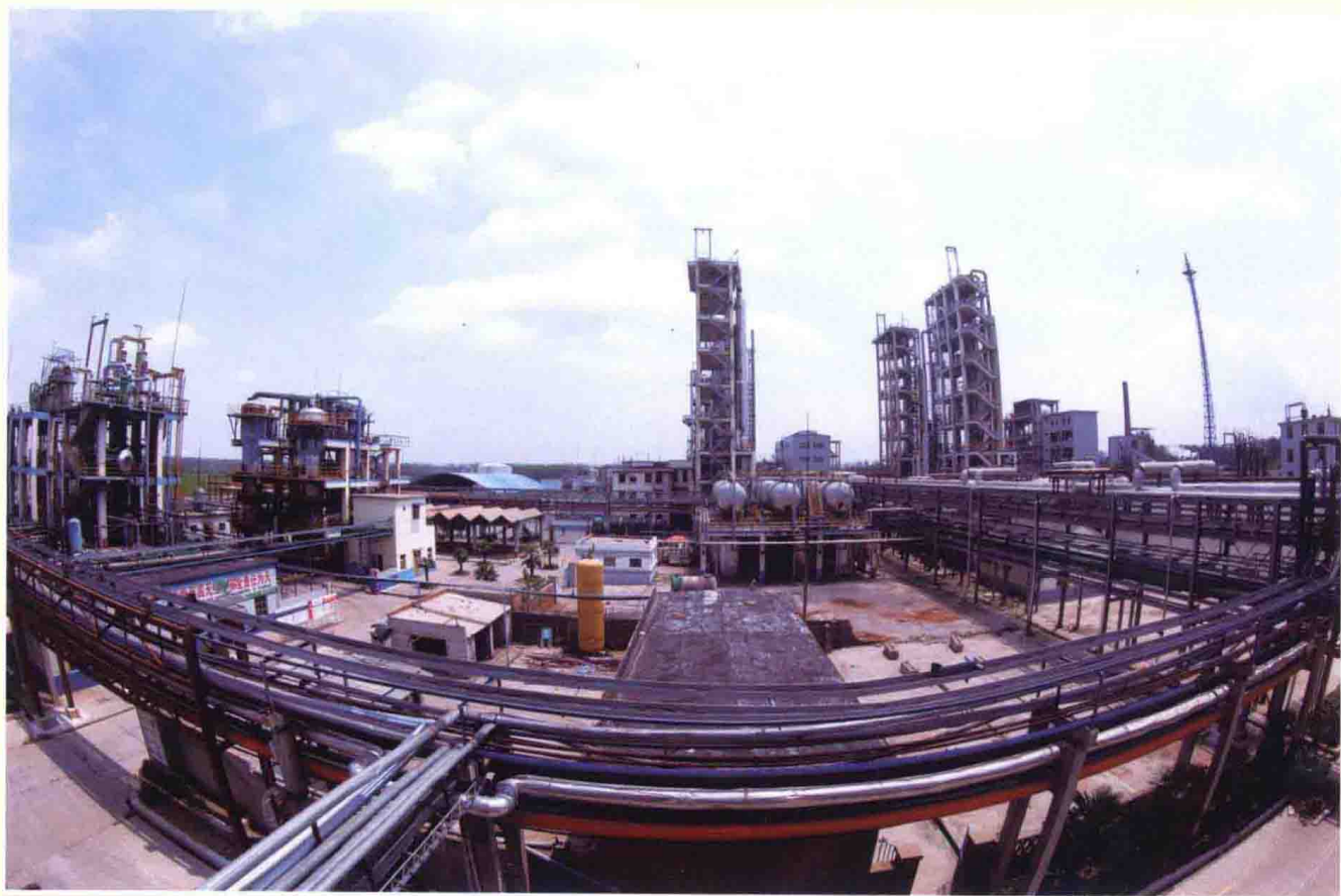
淮河化工生产装置
