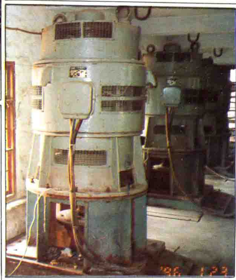
九潭电动排涝站 部分机组
