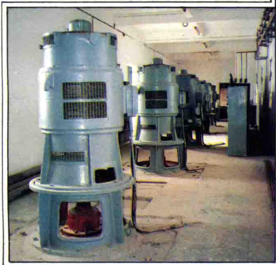
朗环电动排涝站机组
