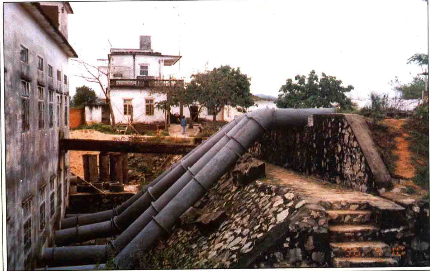
鹿颈坑抽水站
