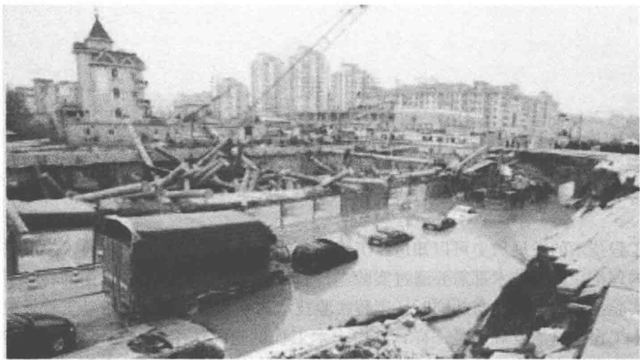
图 1.1.1 杭州地铁工程坍塌事故现场
