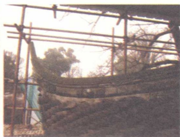
图 2.13 原水戗表面的 粉刷层局部剥落
