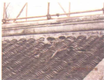
图 2.11 原正脊表面的 粉刷层局部剥落
