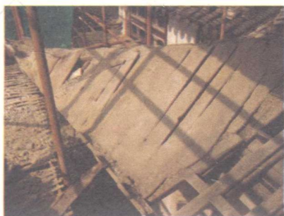
图 2.9 部分摔网板腐朽严重
