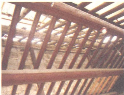
图 2.8 草架椽腐朽严重
