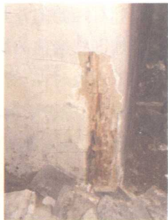
图 2.6 包入墙中的 木柱腐朽
