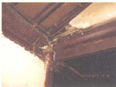
图 2.10 节点处榫卯损坏严重
