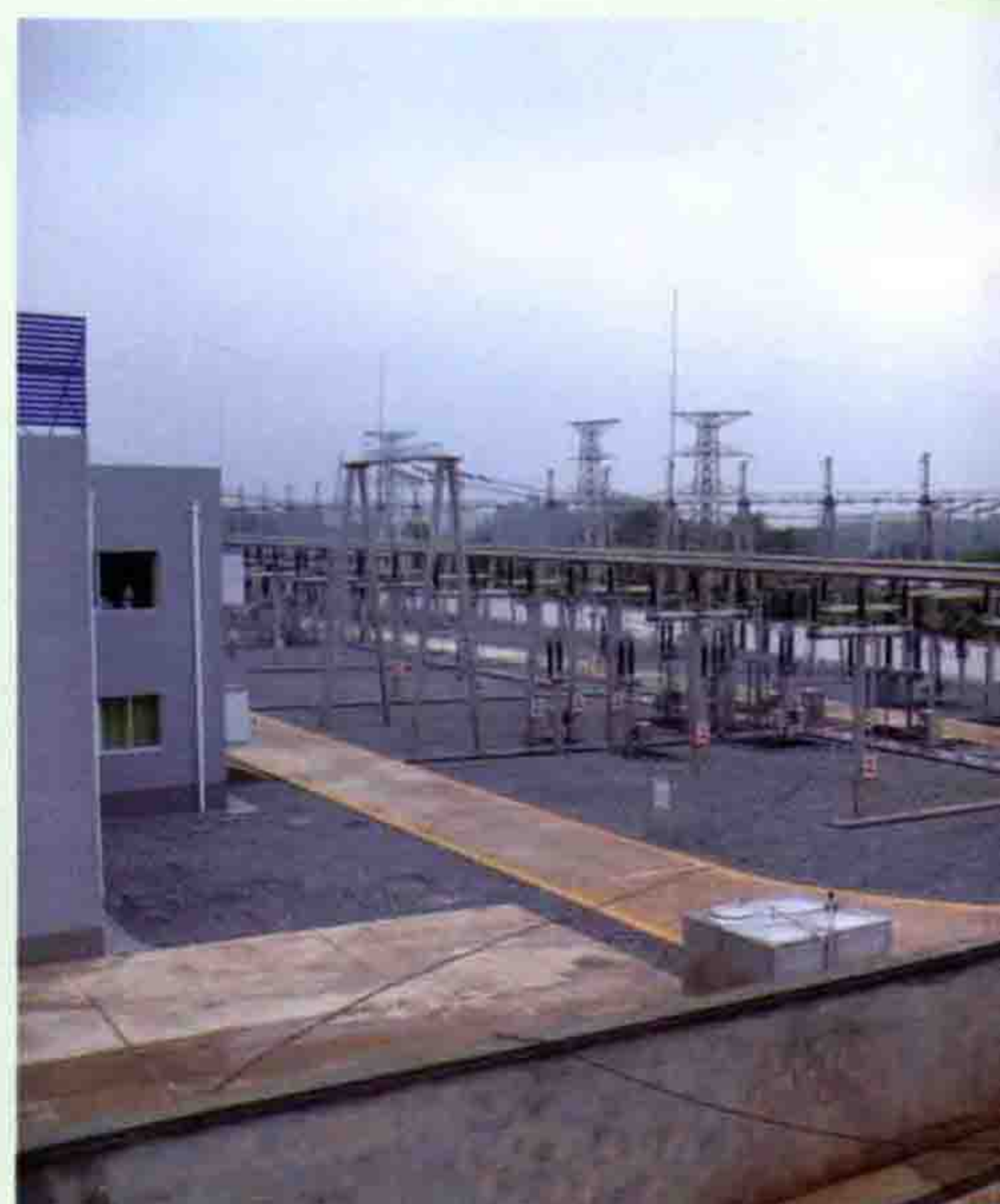
何坝乡220千伏变电站
