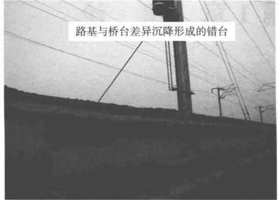
图 1-2 过渡段不均匀沉降
