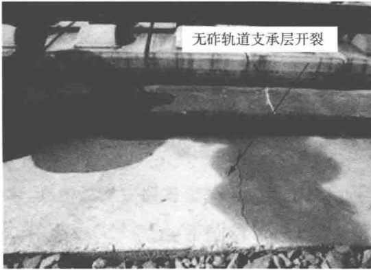
图 1-1 路基不均匀沉降导致无砟轨道支承层开裂
