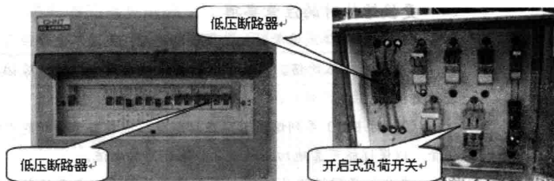
(a) 居民楼开关箱 (b) 工地开关箱
