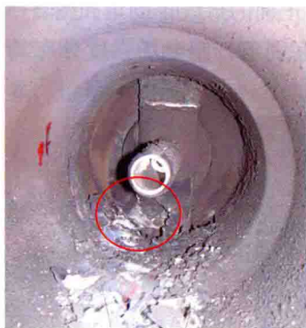
图 2-2 A 相上触头盒内 铜母线排端部烧损缺角
