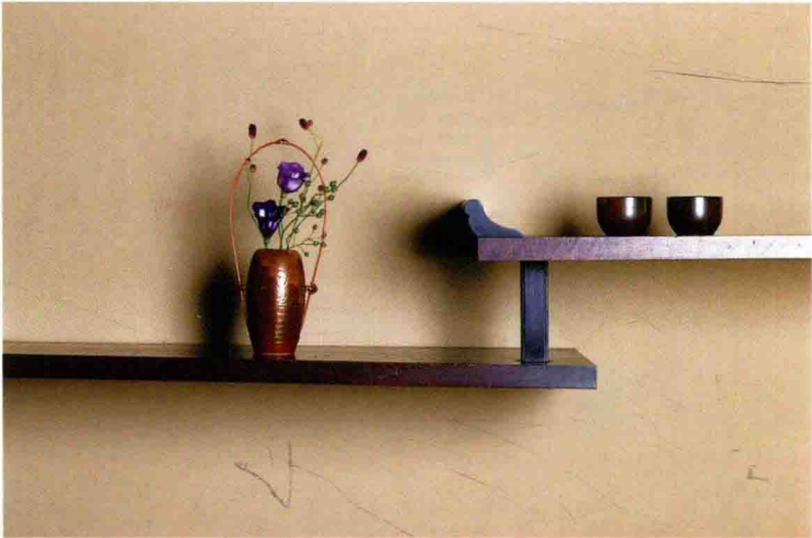
图2-1 合格的乳胶漆涂刷墙面
