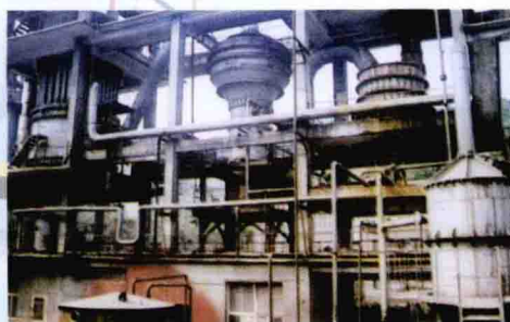
40 万吨 H 2 SO 4 工程
