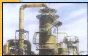
▲ FRP 废气管道(石化工厂)
