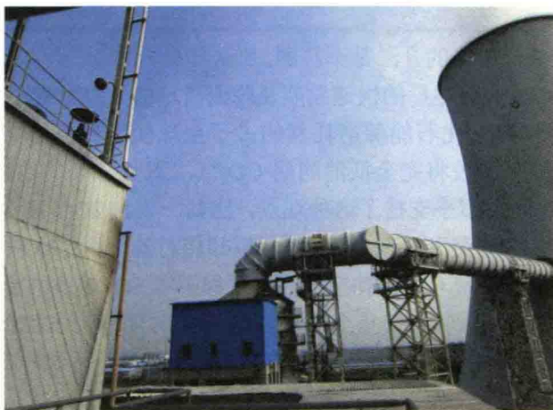
注：左侧是除尘车间，中间是脱硫塔，右侧是烟囱和冷却塔的结合体（拍摄于神华集团国华电力公司三河电厂）。
