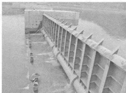
图10 闸门全关位照片
