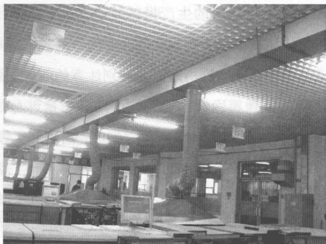
图 1-2 印刷车间排风设施
