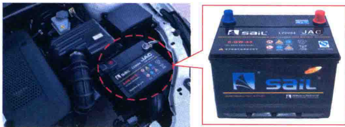
图1-19 蓄电池的安装位置
