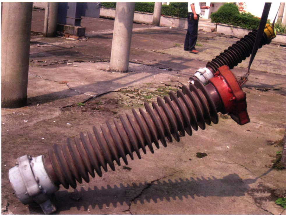
照片 1-011 绵阳安县, 110kV 辕门坝站 (地震烈度IX度), 避雷器断裂掉落, 震害等级为毁坏 (汶川地震)
