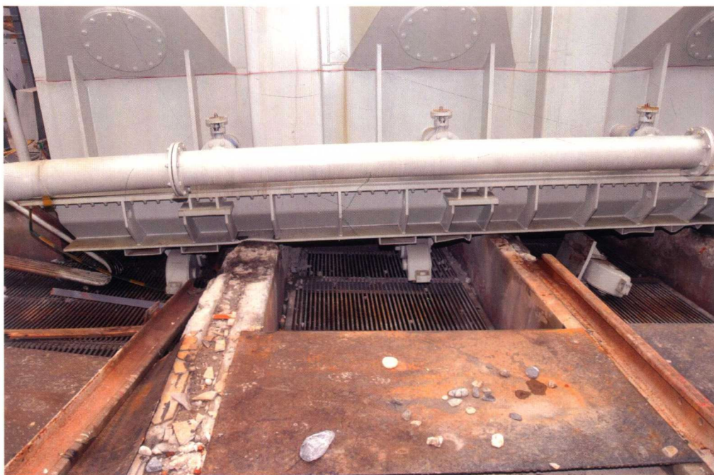
照片 1-010 阿坝州汶川县漩口镇，阿坝铝厂（地震烈度X度），220kV 有载调压变压器 严重移位、从导轨上掉落、导轨破坏、导轮折断，震害等级为毁坏（汶川地震）
