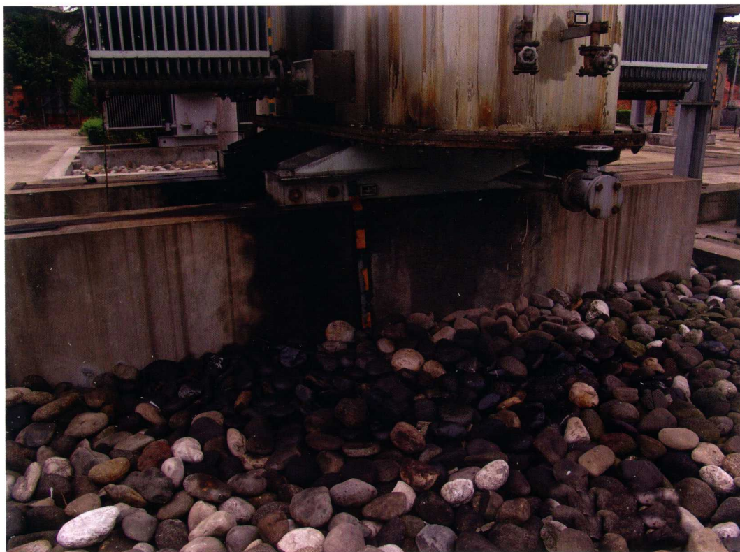
照片 1-008 绵阳安县，35kV 秀水站（地震烈度Ⅷ度）， I # 主变压器严重漏油，震害等级为毁坏（汶川地震）
