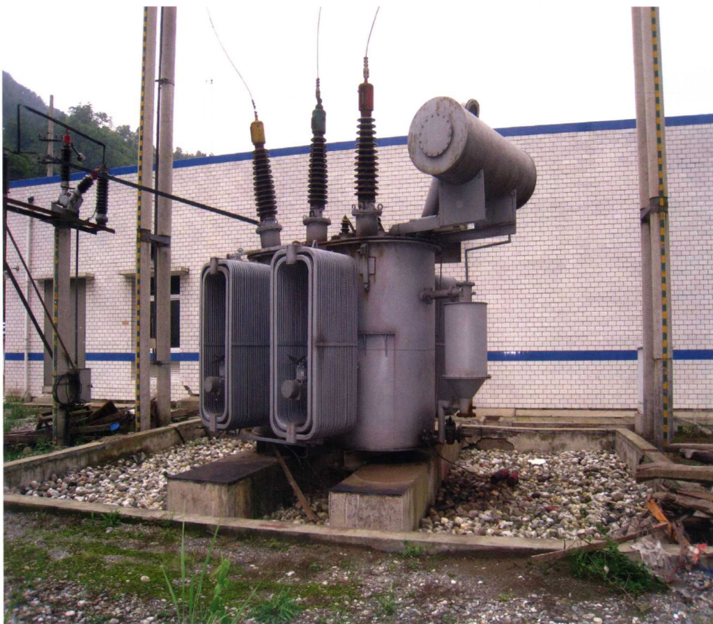
照片 1-009 绵阳北川县，110kV 启明星站（地震烈度XI度）， II#主变压器严重偏移漏油、并被堰塞湖洪水浸泡，震害等级为毁坏（汶川地震）
