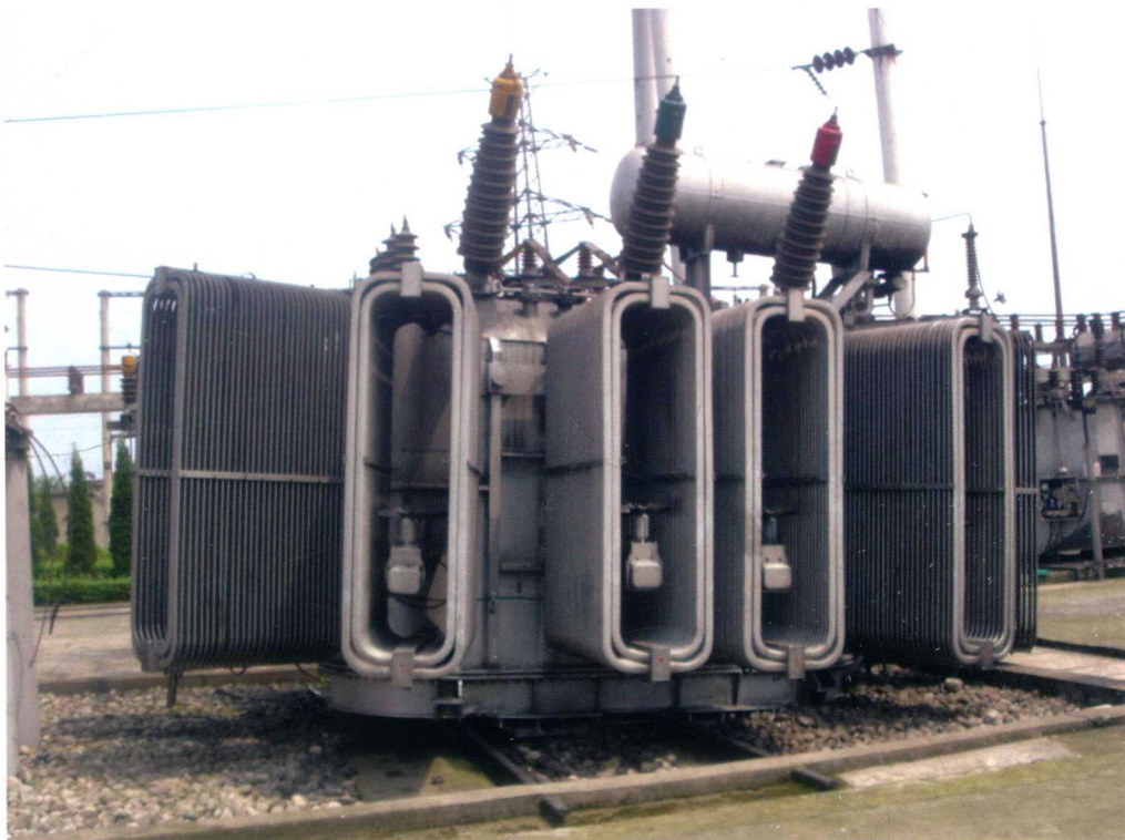
照片 1-003 都江堰市，110kV 灌县站（地震烈度IX度）， II#主变压器严重倾斜、连线拉断，震害等级为中等破坏（汶川地震）
