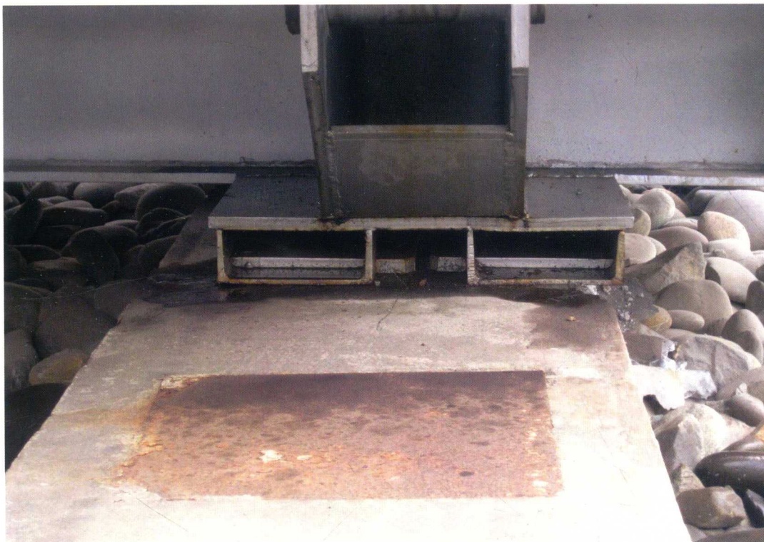
照片 1-007 广元利州区，110kV 三堆站（地震烈度Ⅷ度）， I # 主变压器本体位移 6cm、渗油，震害等级为中等破坏（汶川地震）
