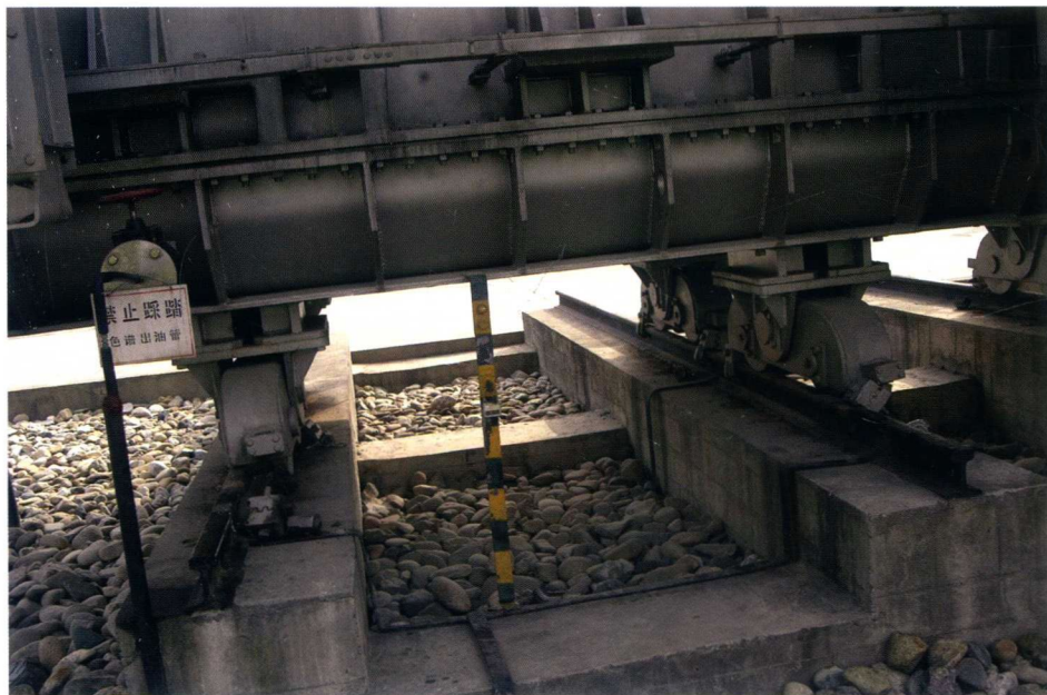
照片 1-002 广元利州区, 220kV 袁家坝站 (地震烈度Ⅷ度), I#主变压器移位、滑轮脱轨、固定件损坏, 震害等级为中等破坏 (汶川地震)
