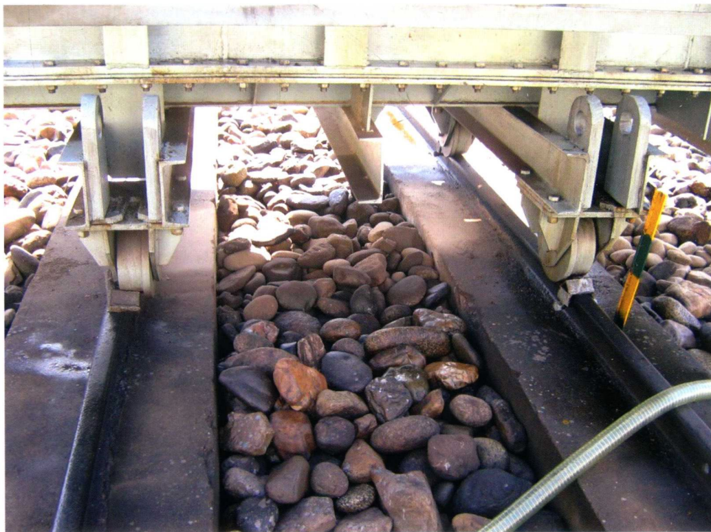
照片 1-004 广元青川县，110kV 竹园站（地震烈度VIII度）， I#主变压器移位、漏油，震害等级为中等破坏（汶川地震）
