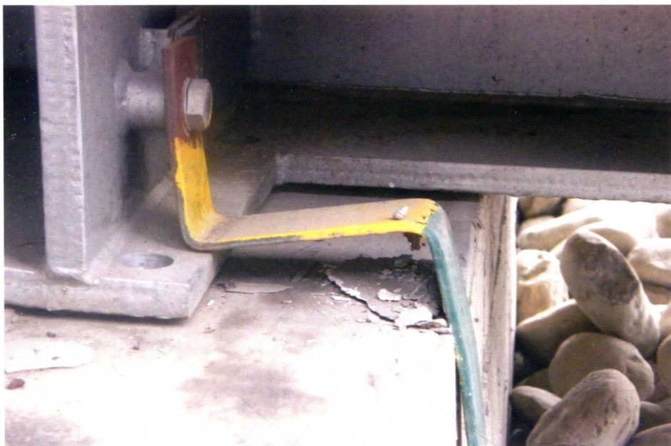
照片 1-001 绵阳安县, 110kV 花菱站 (地震烈度Ⅶ度), I#主变压器移位, 震害等级为基本完好 (汶川地震)
