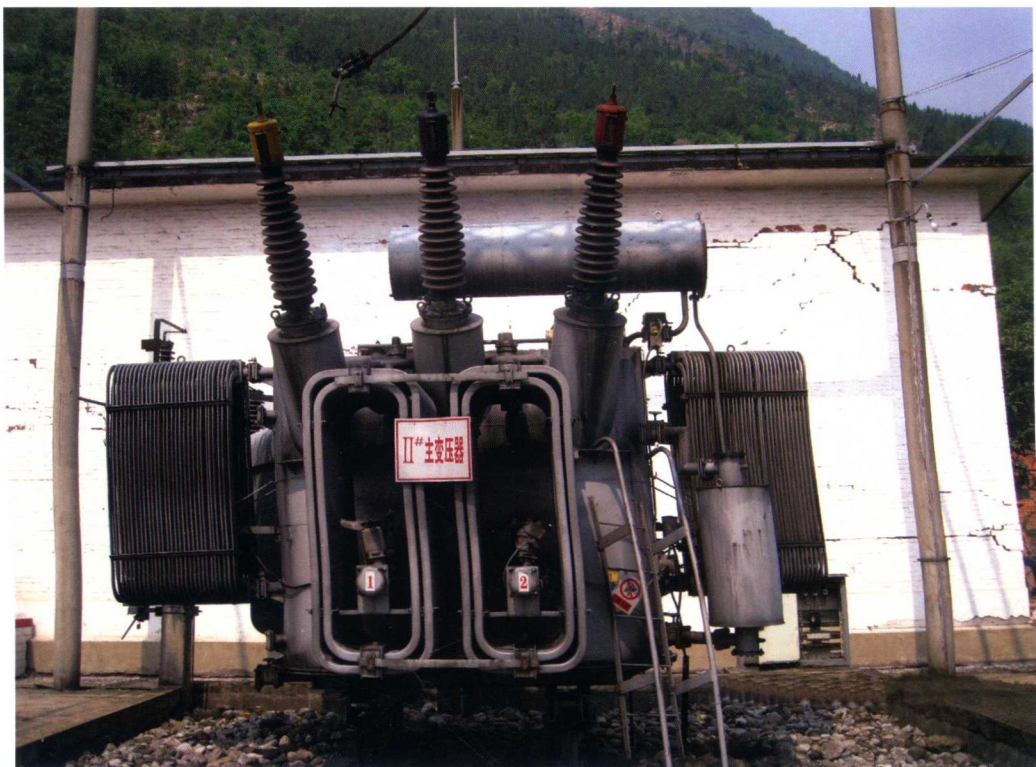
照片 1-005 绵阳安县永安镇, 110kV 辕门坝站 (地震烈度IX度), II#主变压器漏油, 震害等级为中等破坏 (汶川地震)
