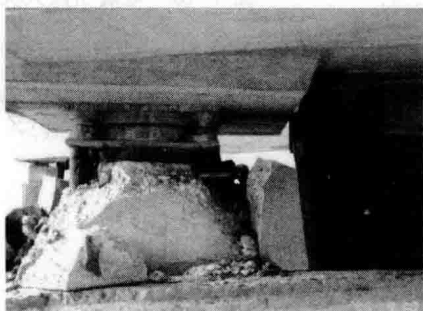
图 1.9 桥梁支座压碎
