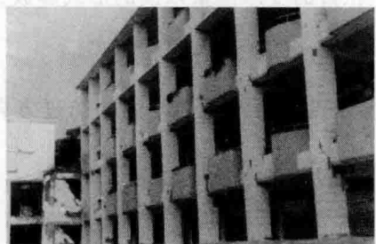
图 1.11 梁柱接头破坏
