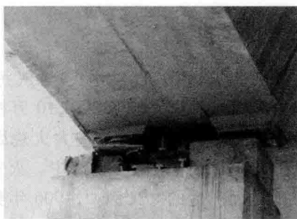
图 1.8 桥梁支座滑移
