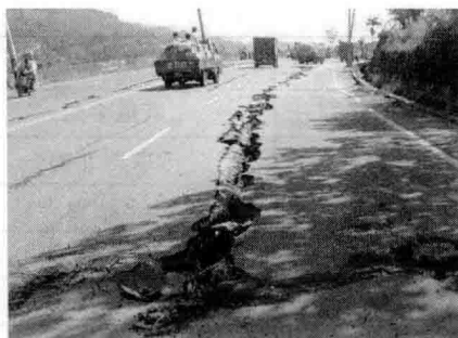
图 1.4 地震引起的道路裂缝
