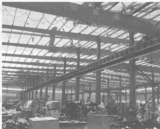
图 1-1 遭受台风破坏的轻钢厂房
