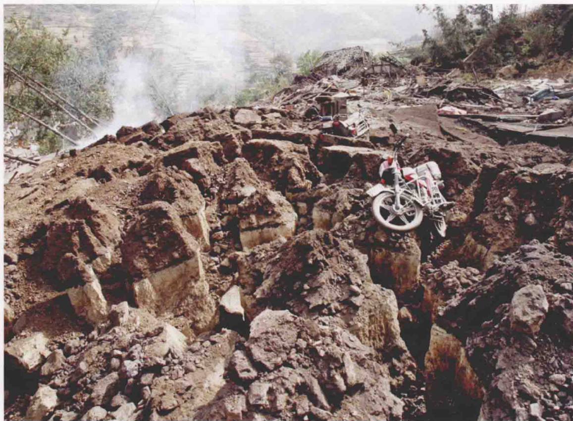
平武南坝镇石坎办事处震损的村道
