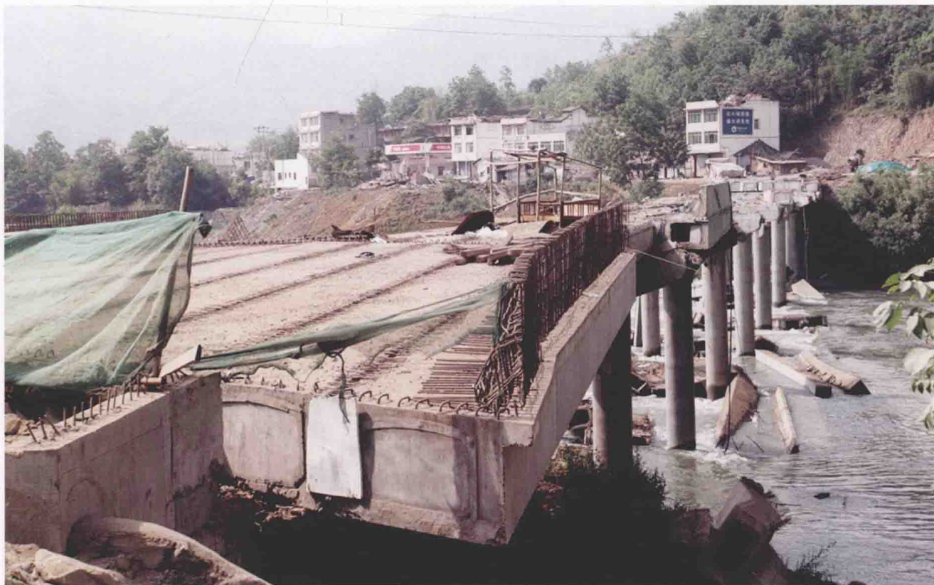
被损毁的建设中的桥梁
