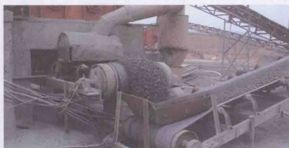
图 3.3.5-1 干式除尘装置
