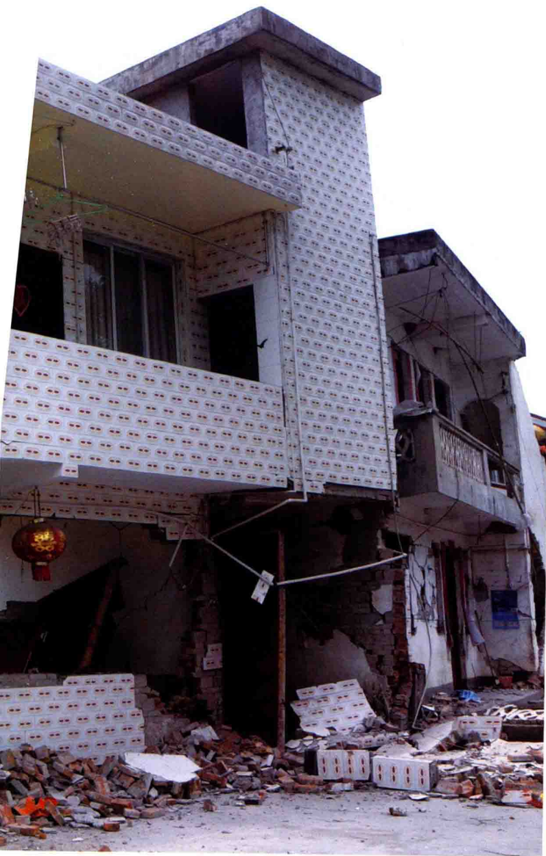
芦山县龙门乡。被震毁的房屋。
