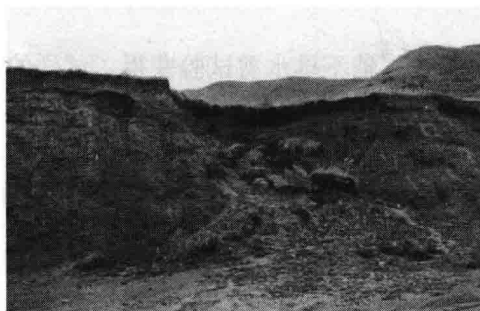
图 1-3 路基施工前未建立临时排水系统
