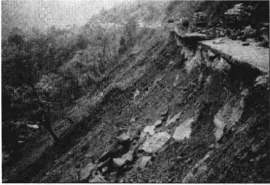
图 1-2 高填方路堤边坡坍塌
