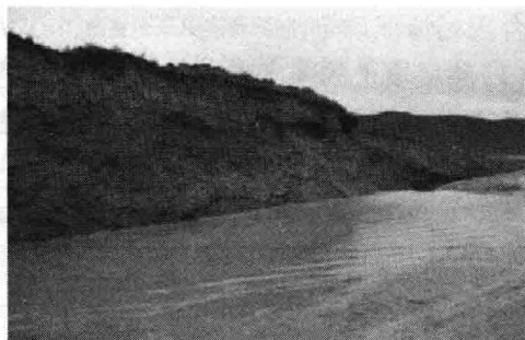
图 1-4 路基排水系统不畅通
