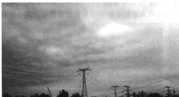
图 0-9 660kV 高压直流输电线路
