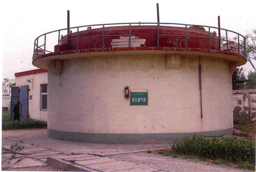
沼气系统-储气罐
