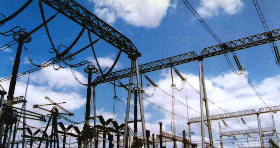
神头第二发电厂 50 万 升压站
