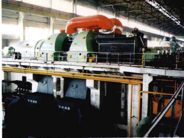
漳泽发电厂发电机房
