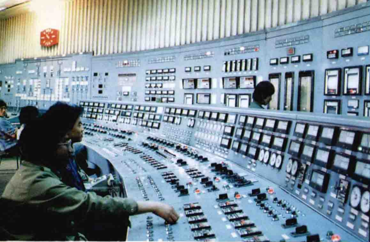
大同第二发电厂主控室
