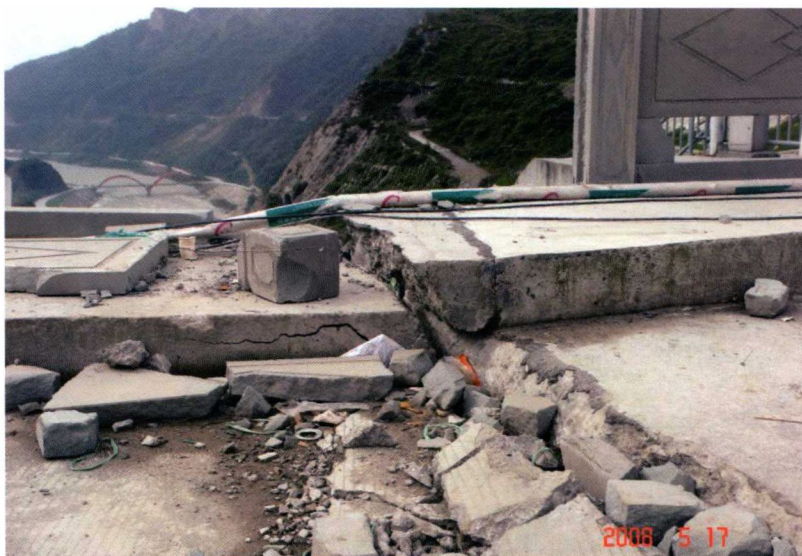
图 1.4 坝顶与右岸边坡间的错台沉降
