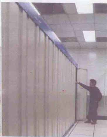
枝城市新开通的 7000 门程控电话主体机房，工作 人员正在精心操作。
