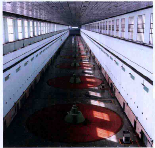
电站厂房内部
