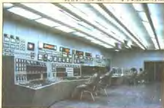
石洞口发电厂3号机组控制室
