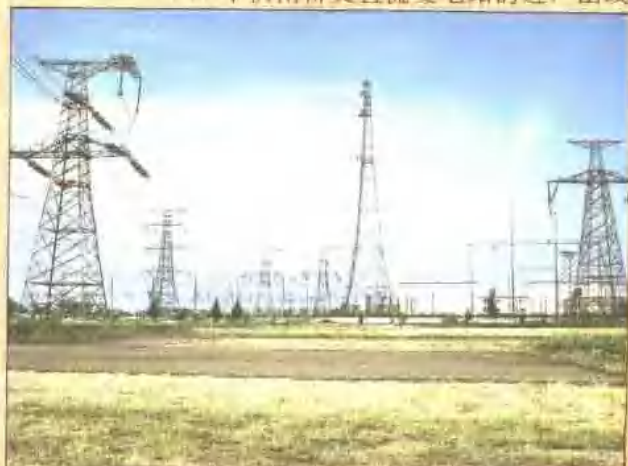
500 千伏南桥交直流变电站的进、出线
