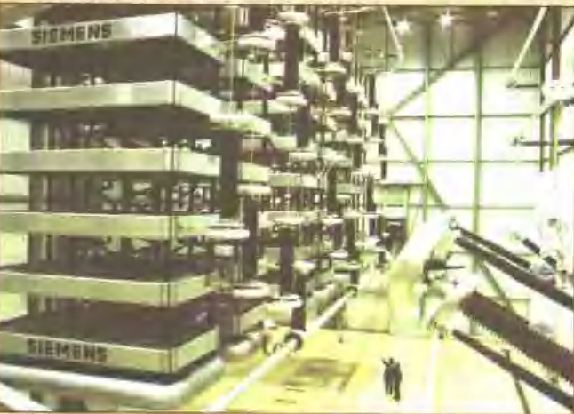
500 千伏南桥交直流变电站阀厅
