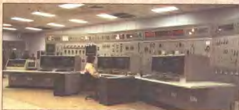
华能石洞口第二发电厂控制室
