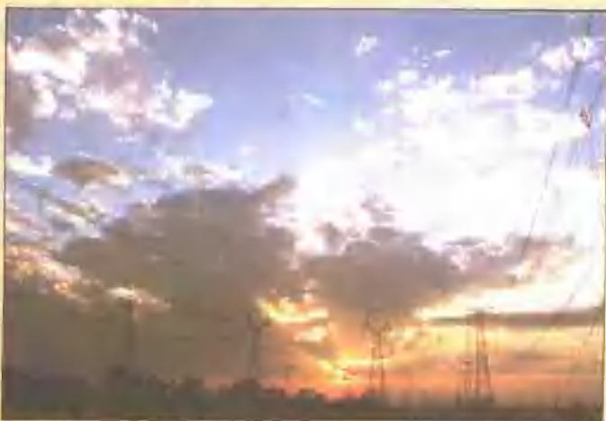
500 千伏交直流输电线路
