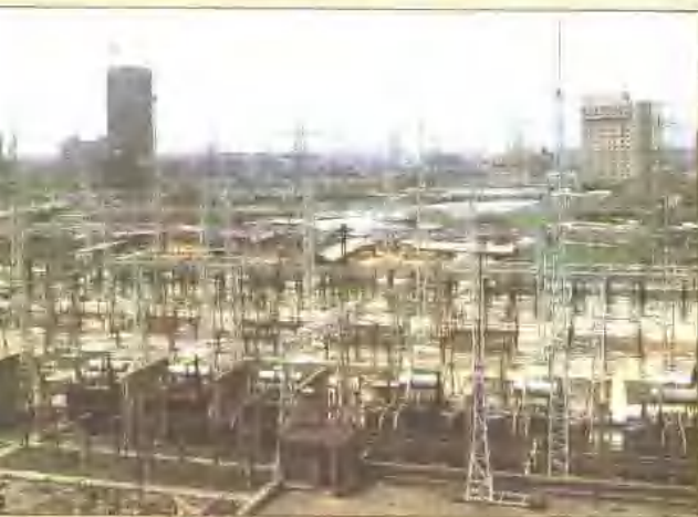
上海第一座 220 千伏枢纽变电站——西郊变电站
