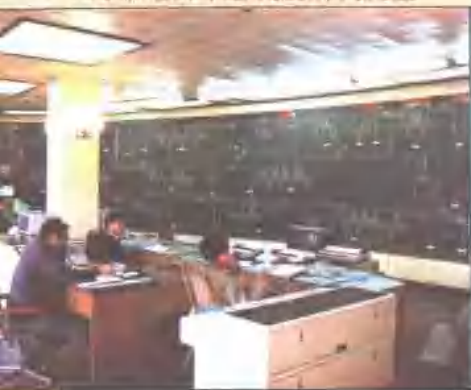
上海市电力中心调度所调度室
