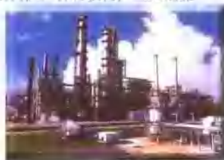
玉门油田分公司炼化总厂已有64年的发展历程，主要生产装置达到国内先进水平。图为炼化总厂250万t/a常减压装置。
