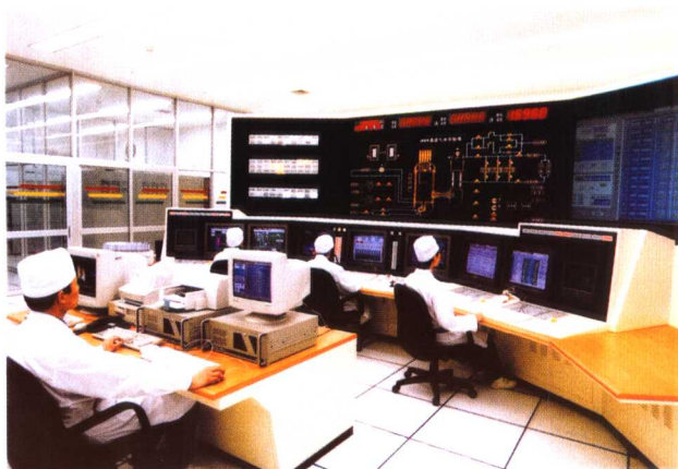
图28 中国第一座高温气冷堆 HTR-10 控制室
