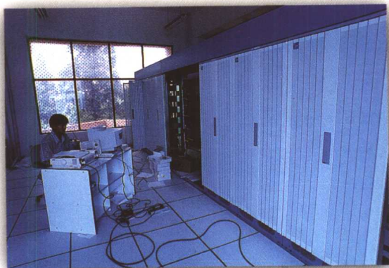
5ESS 程控交换设备
