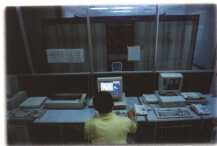
S-1240 型 1200 门程控机房
