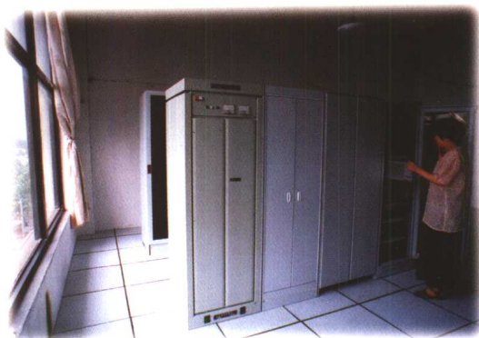
现代化数据通信机房
