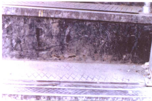
图 4-8 门槛立板腐蚀穿透(第 62 页)
