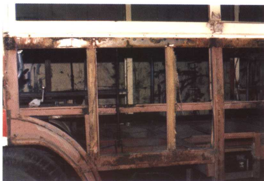
图 4-13 骨架与面板间的缝隙腐蚀(第 62 页)
