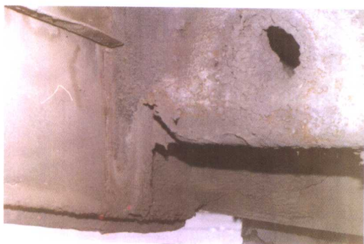
图 4-15 汽车大梁腐蚀穿透(第 63 页)
