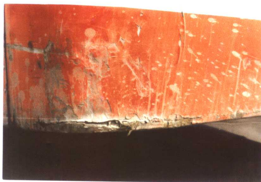
图 4-5 裙带区面板腐蚀穿透(第 62 页)
