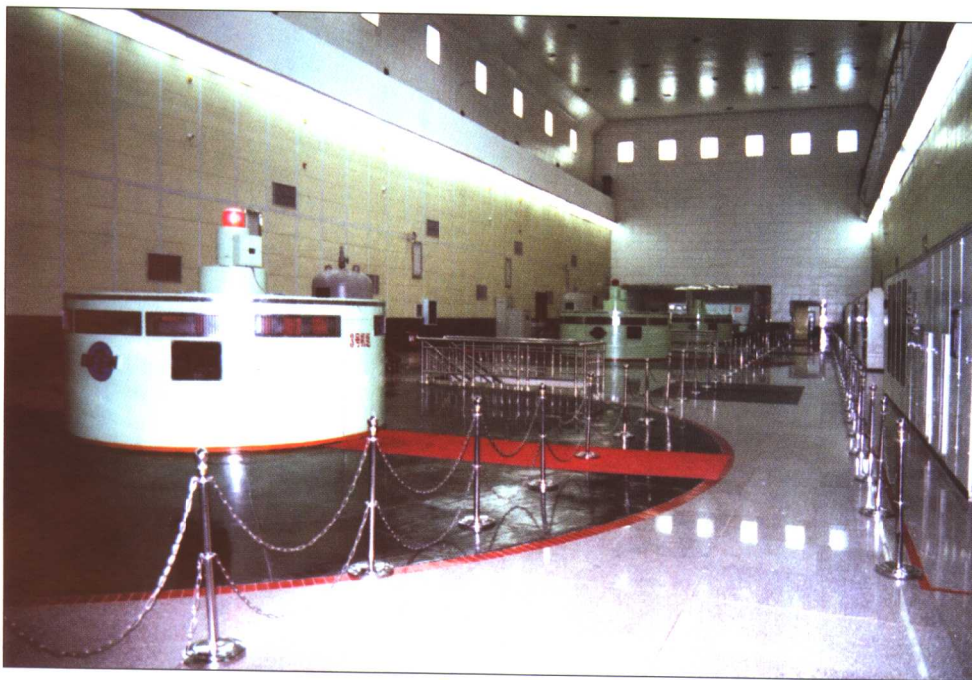
江垭水利枢纽水电站的地下厂房主厂房（摄影：严冬明）
