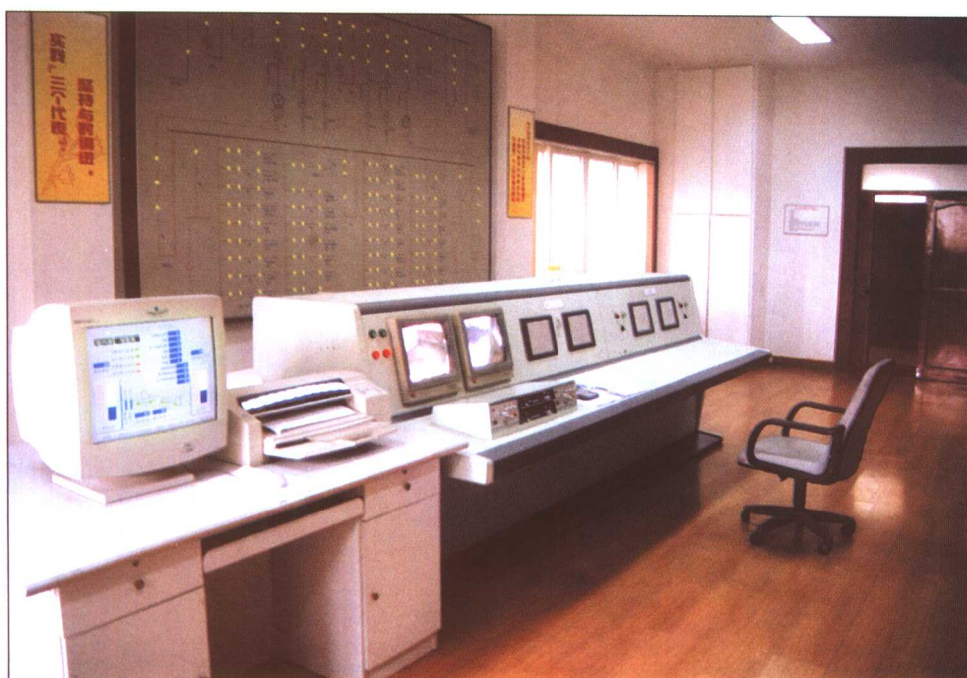
张家塘泵闸主控室
