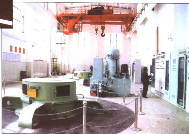
桃林口水库水电站 2 台 10MW 发电机组（摄影：刘玉辉）
