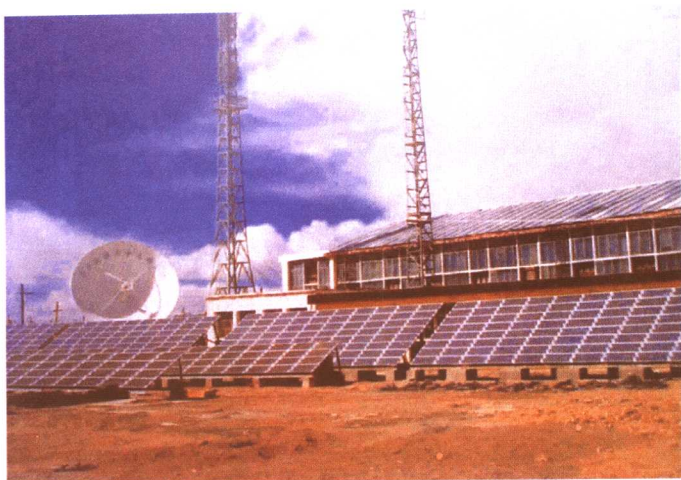
图 12 太阳能光伏发电系统 (80kW p , 西藏)
