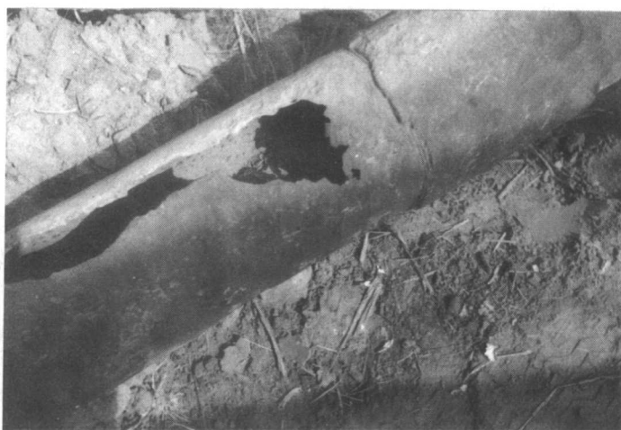
图 1—2 套管腐蚀穿孔形貌
