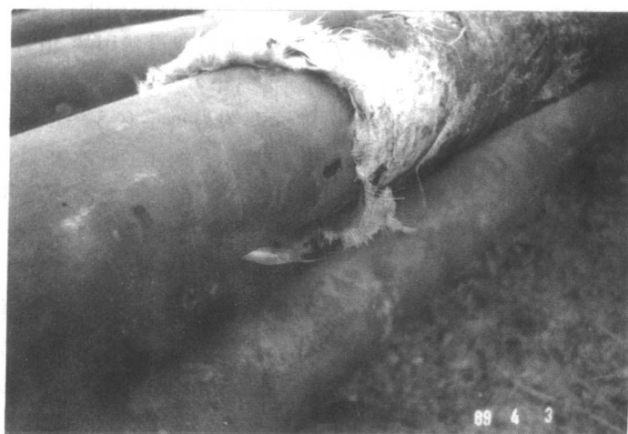
图 1—3 输送管腐蚀穿孔形貌
